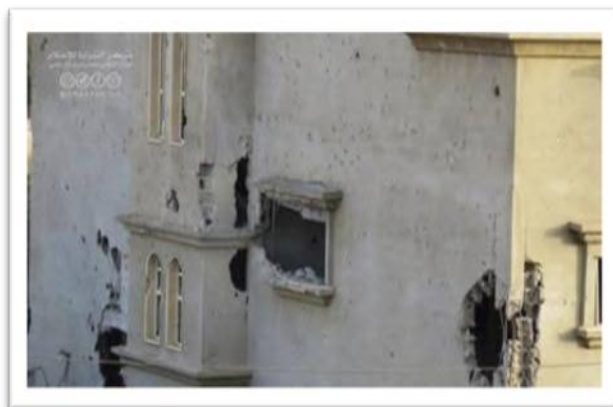
شكل (3): آثار إصابات مباشرة في واجهات المباني السكنية المصدر: تصوير ميداني من سكان المنطقة (قبل النزوح) – معالجة الباحثة
